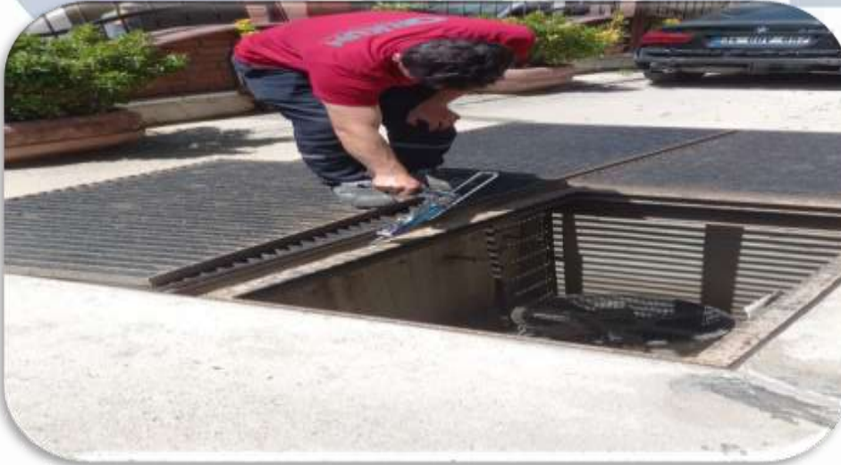
Otopark girişi, demir mazgallarda ses yalıtımı yapılmıştır.
