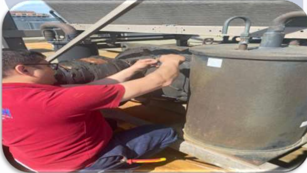
Soğutma sisteminin arızalı olan 2 adet sensör ve 1 adet hava alma purjörü yenileri ile değiştirilmiştir.
