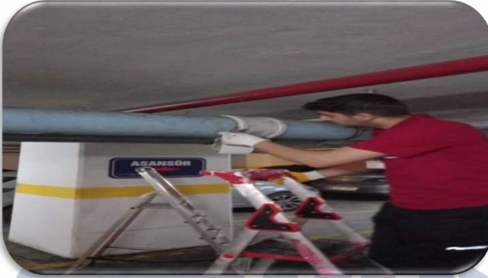
-2 Kapalı otopark pimaş çatlağına teknik müdahalede bulunulmuştur.
