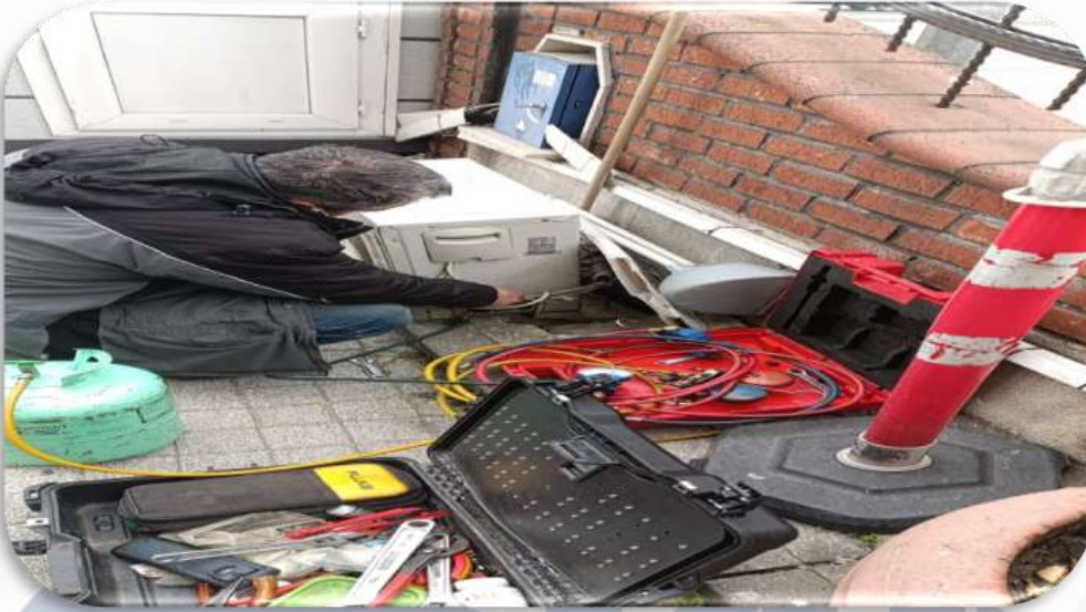
Güvenlik kabini klima periyodik kontrol ve bakımları gerçekleştirilmiştir.
