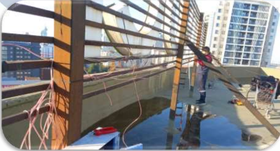
Çatı katındaki ışıklı Vetro City tabelasının arızalı ledleri değiştirilmiştir.
