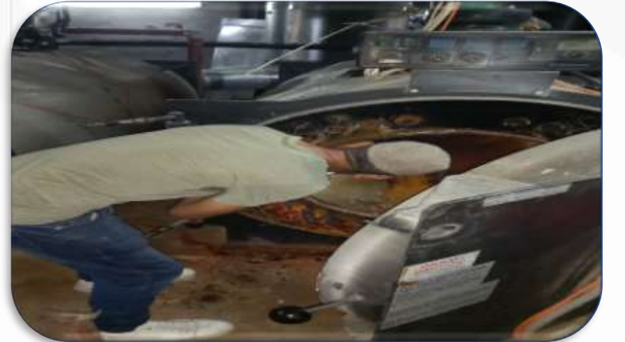
Kışa hazırlık kapsamında, ısı kazanları kontrolleri yapılmış, eksikler tespit edilmiştir.
