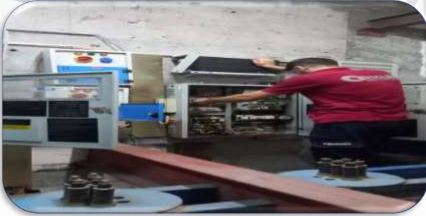
B Blok sağ asansör 2 adet akü değişimi yapılmıştır.
