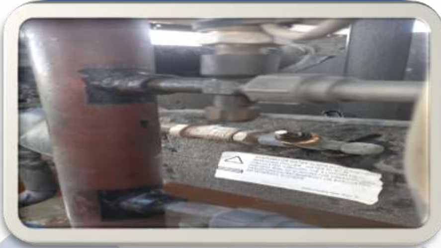
A Blok fancoil sisteminin arızalı parçası: SUCTION TRANDUCER, yenisi ile değiştirilmiştir.
