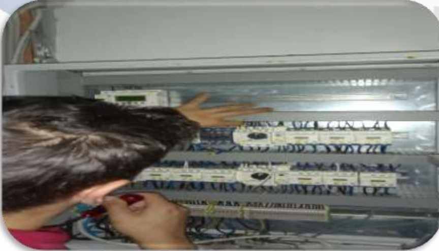
1 nolu Hidroforun, 3 nolu arızalı kontaktörü yenisi ile değiştirilmiştir.
