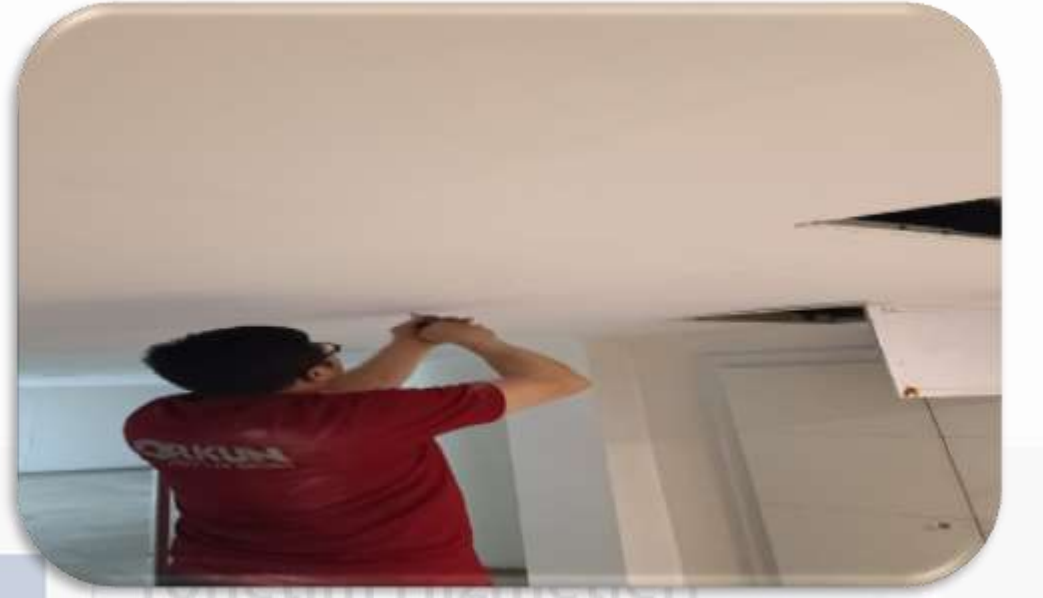
Soğutma Sistemi 1.kat su kaçağı arızasına ilişkin kontroller sağlanmıştır.
