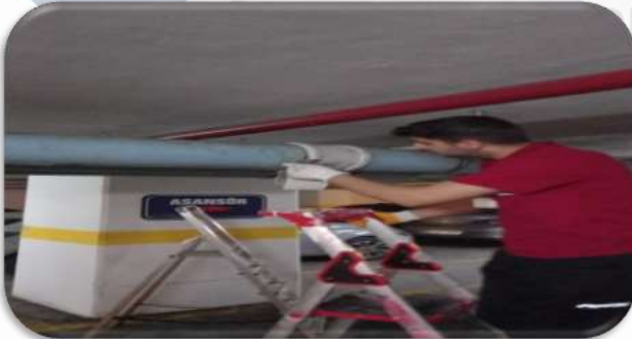
-2 Kapalı otopark pimaş çatlağına teknik müdahalede bulunulmuştur.
