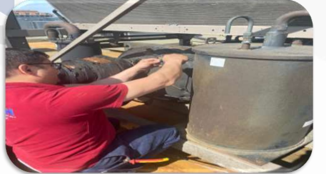
Soğutma sisteminin arızalı olan 2 adet sensör ve 1 adet hava alma purjörü yenileri ile değiştirilmiştir.
