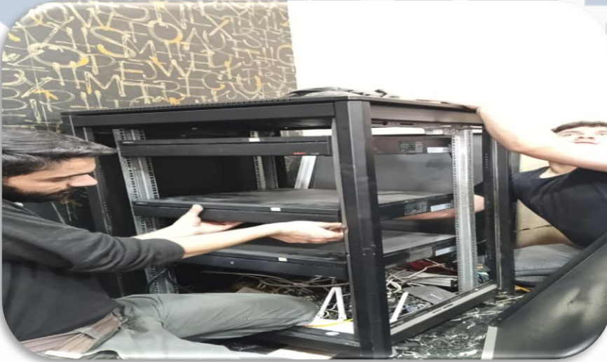
Kamera sistemi periyodik bakım faaliyeti gerçekleştirilmiştir.
