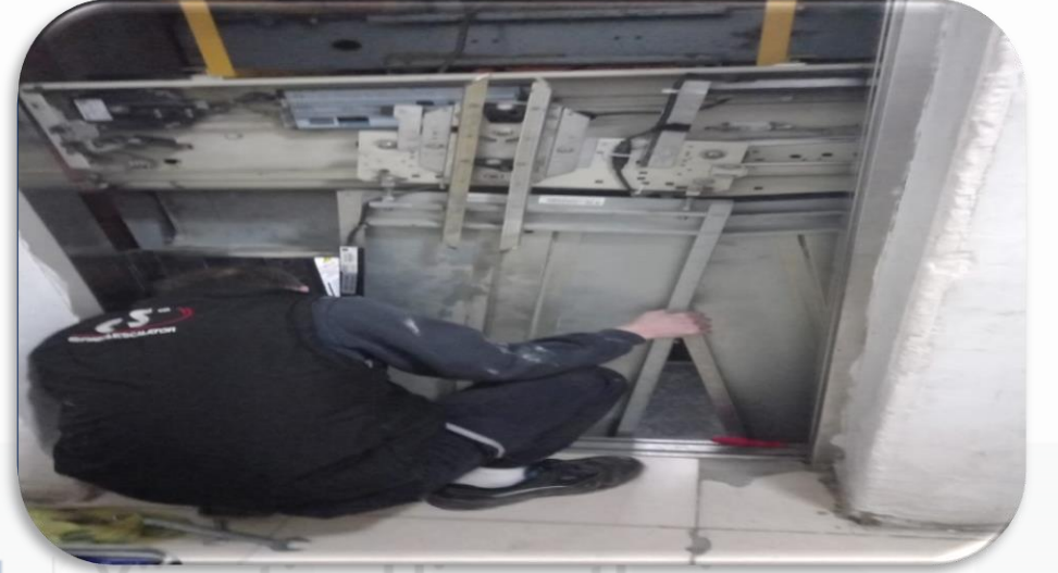
A Blok yük asansörü kapı arızası giderilmiştir.
