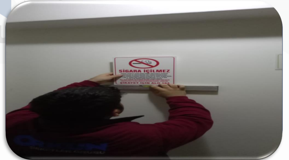
Yangın merdivenlerindeki sigara içilmez uyarı levhaları yenilenmiştir.
