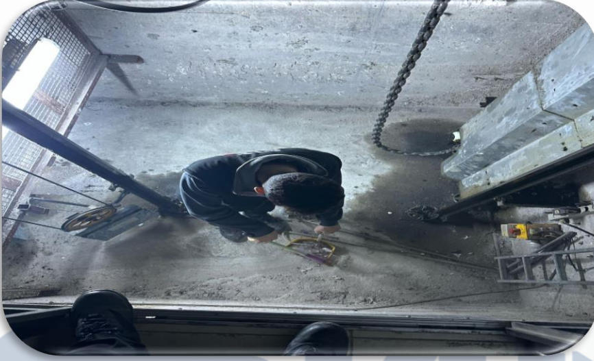
Asansörlerin aylık bakım faaliyeti gerçekleştirilmiştir.
