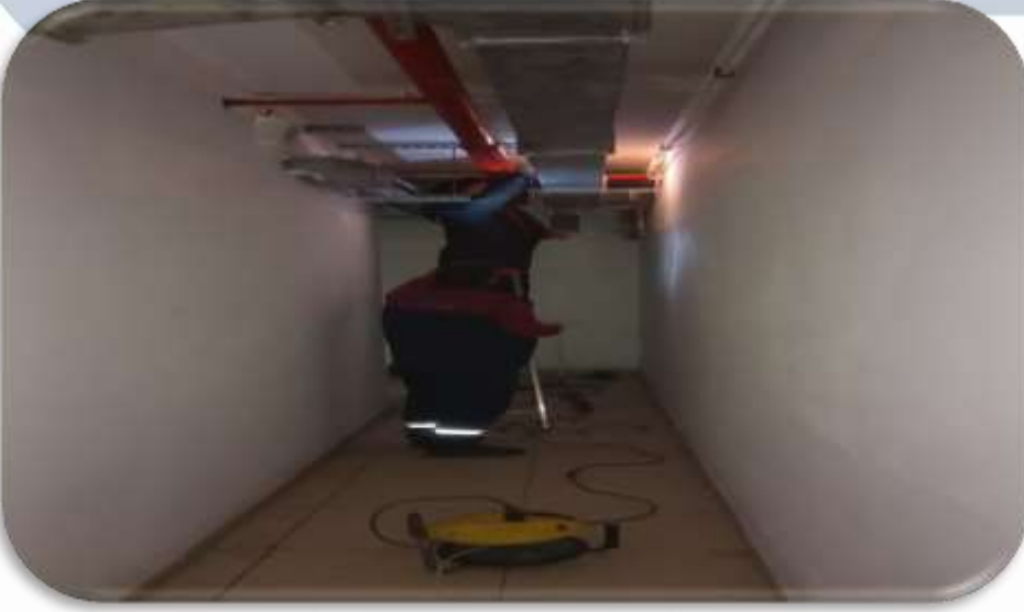
Bina geneli aydınlatma hasar kontrolleri sağlanmıştır.
