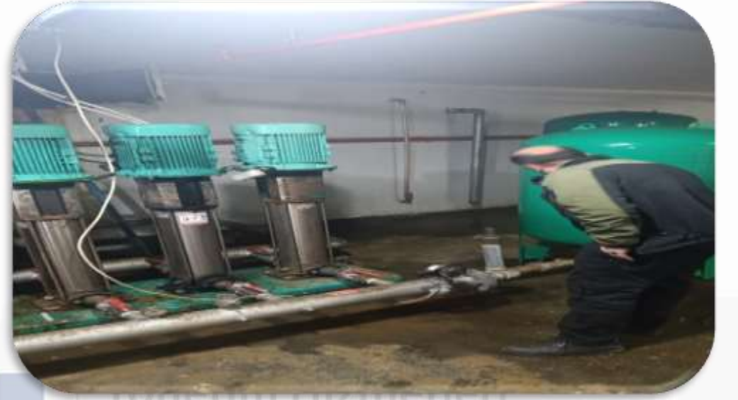
Pompa grubu kontrolleri saėlanmıŖtır.
