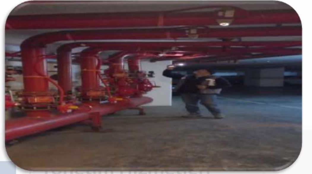
Yangın mekanik sistemi kontrolleri sağlanmıştır.
