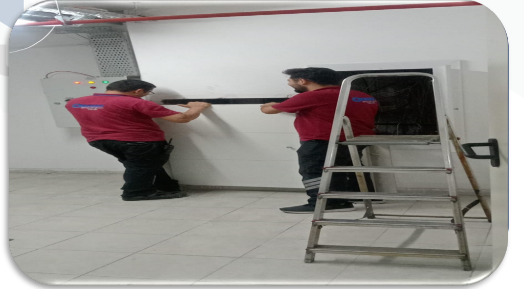
Şaft kapaklarının hasar kontrolleri gerçekleştirilmiştir.
