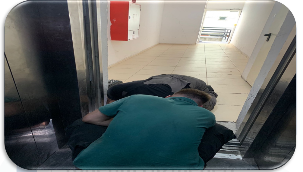
A Blok yük asansörü kapı arızası giderilmiştir.
