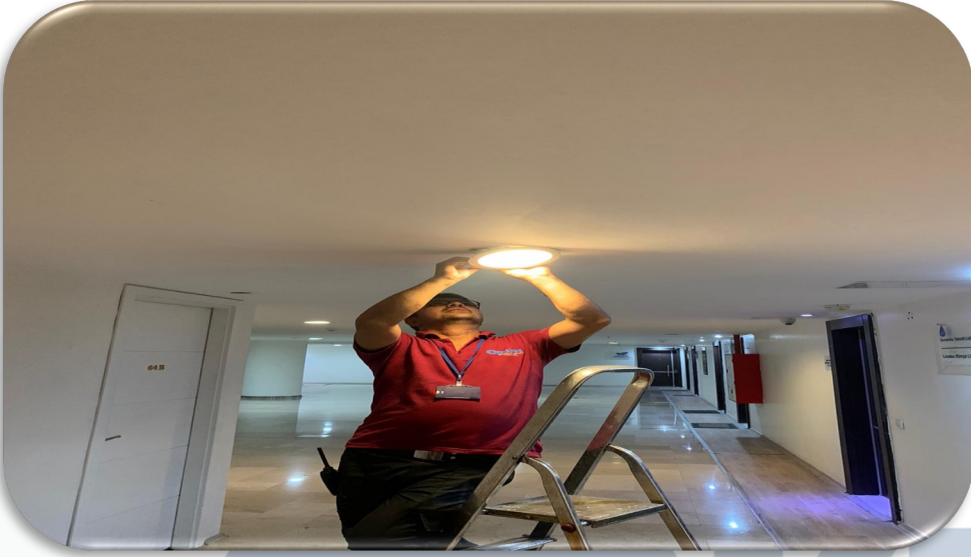
Bina geneli aydınlatma hasar kontrolleri sağlanmıştır.
