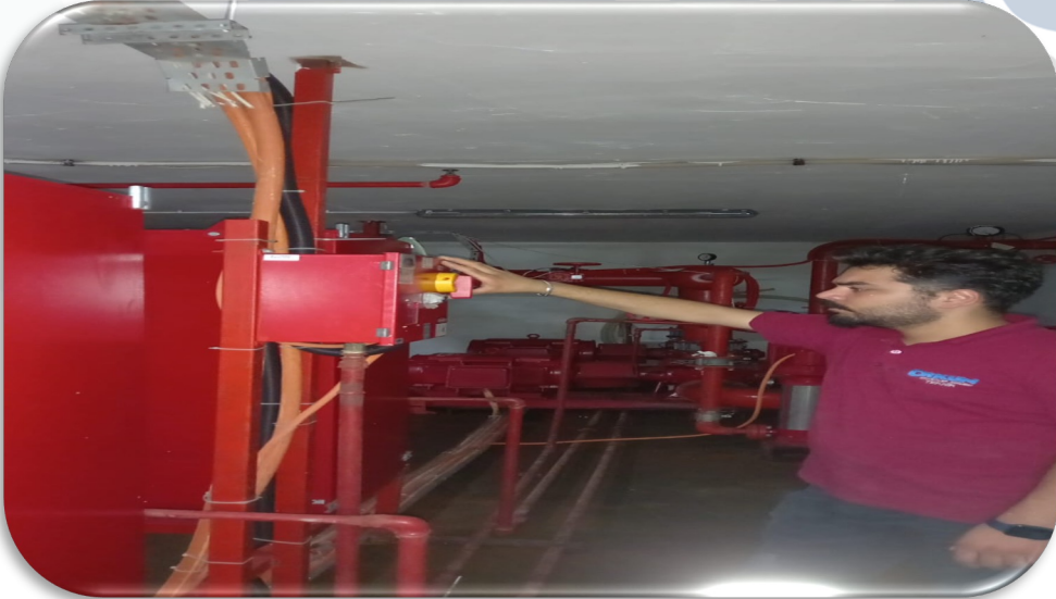
Yangın mekanik sistemi periyodik kontrolleri sağlanmıştır.
