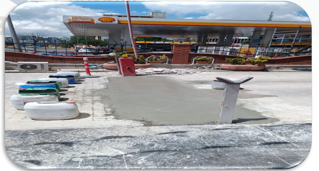
Otopark girişinde zemin bozukluğu beton uygulaması ile düzeltilmiştir.
