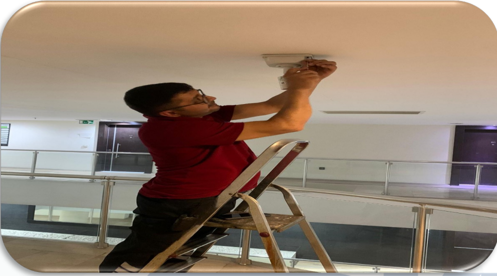
Ortak alan kameralarının trafo kontrolleri gerçekleştirilmiştir.
