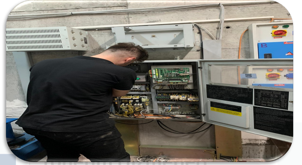
Asansörlerin aylık bakım faaliyeti gerçekleştirilmiştir.
