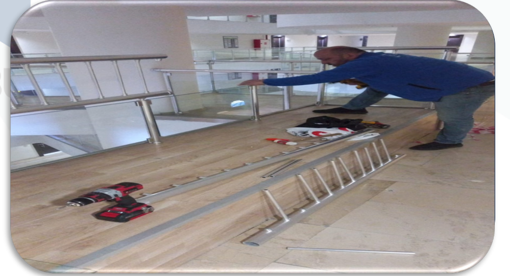
4. kat ortak alan kırık camı yenisi ile değiştirilmiştir.
