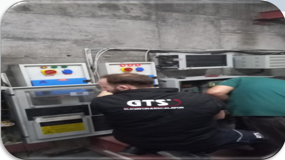
Asansörlerin aylık bakım faaliyeti gerçekleştirilmiştir.
