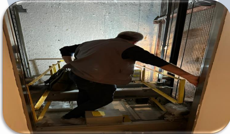
Asansörlerin aylık bakım faaliyeti gerçekleştirilmiştir.
