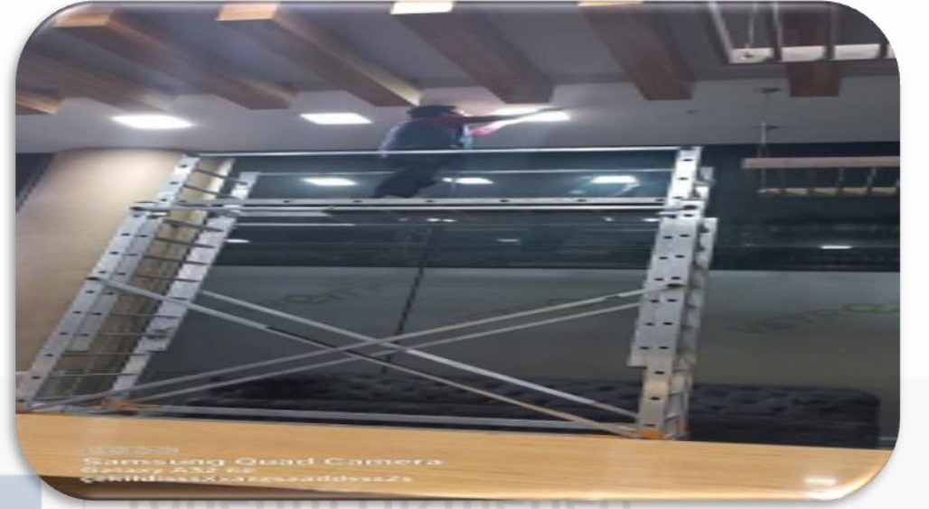
Lobilerin arızalı tavan aydınlatmaları yenilenmiştir.
