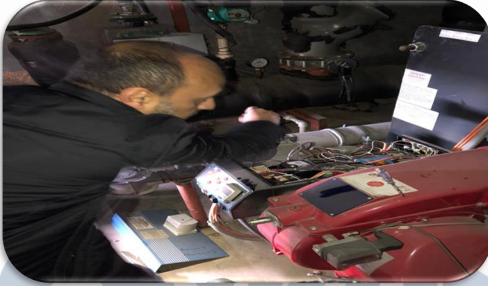
Kazan sistemi periyodik kontrolleri gerçekleştirilmiştir.
