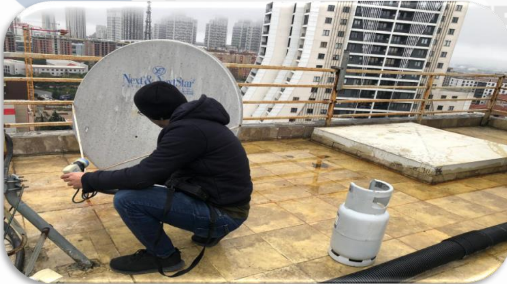
Uydu sistemi periyodik kontrolleri gerçekleştirilmiştir.
