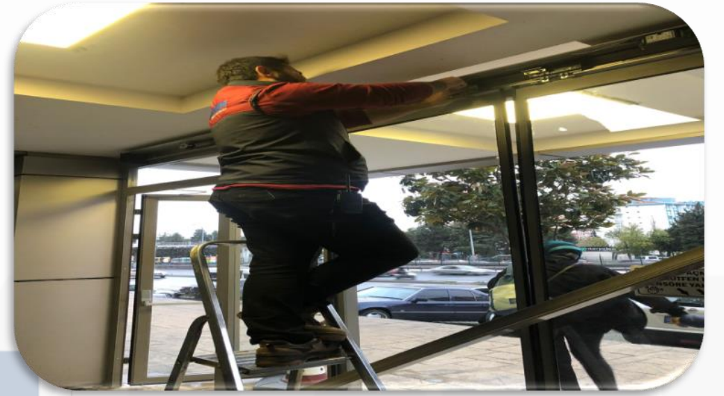
Bina giriş fotoselli kapılarının periyodik kontrolleri sağlanmıştır.
