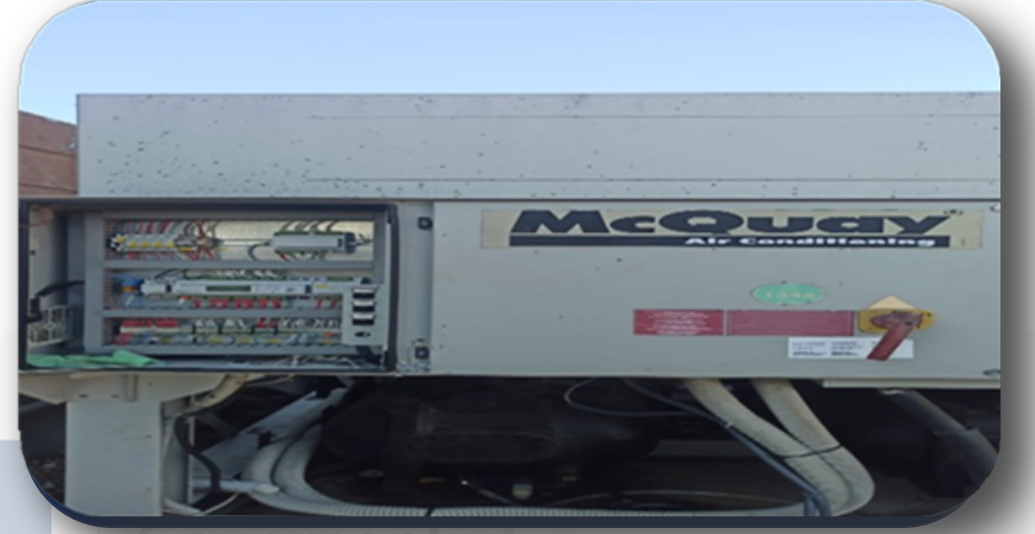
1 ve 2 Nolu Chiller Bakımları, kış kapanışı
