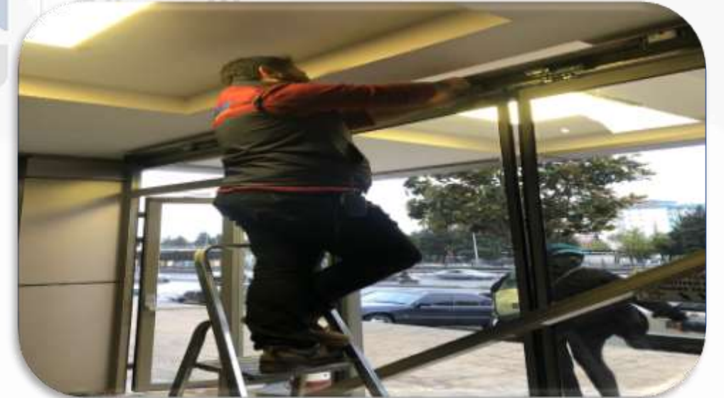
Bina giriř fotoselli kapılarının periyodik kontrolleri saęlanmıřtır.
