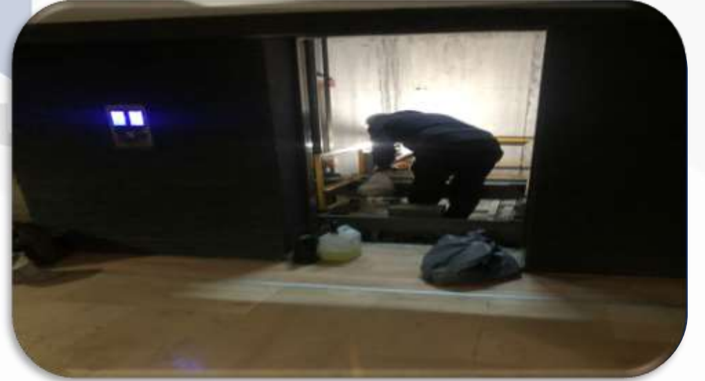
Asansörlerin aylık bakım faaliyeti gerçekleştirilmiştir.
