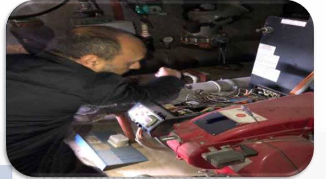
Kazan sistemi periyodik kontrolleri gerçekleştirilmiştir.
