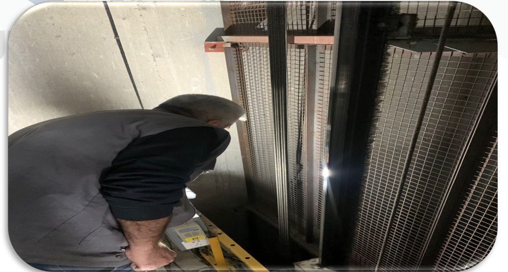
Asansörlerin aylık bakım faaliyeti gerçekleştirilmiştir.
