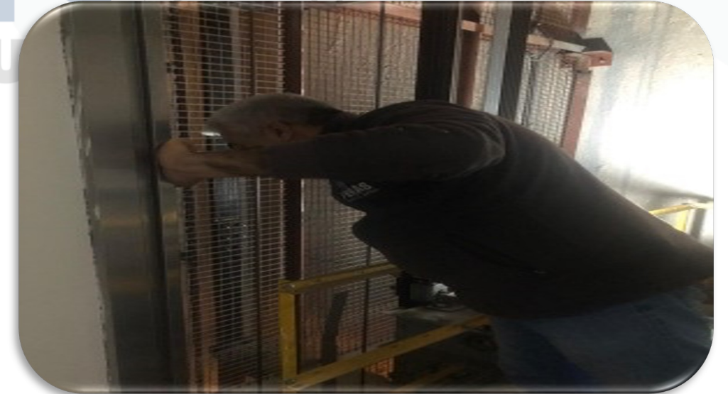
Asansörlerin aylık bakım faaliyeti gerçekleştirilmiştir.
