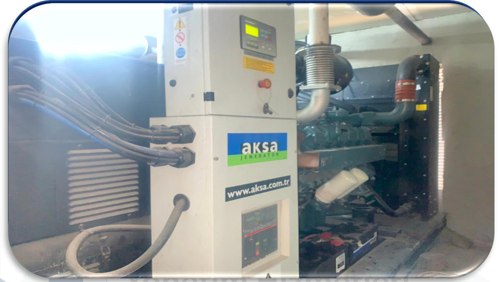
Jeneratörlerin periyodik kontrolleri gerçekleştirilmektedir.
