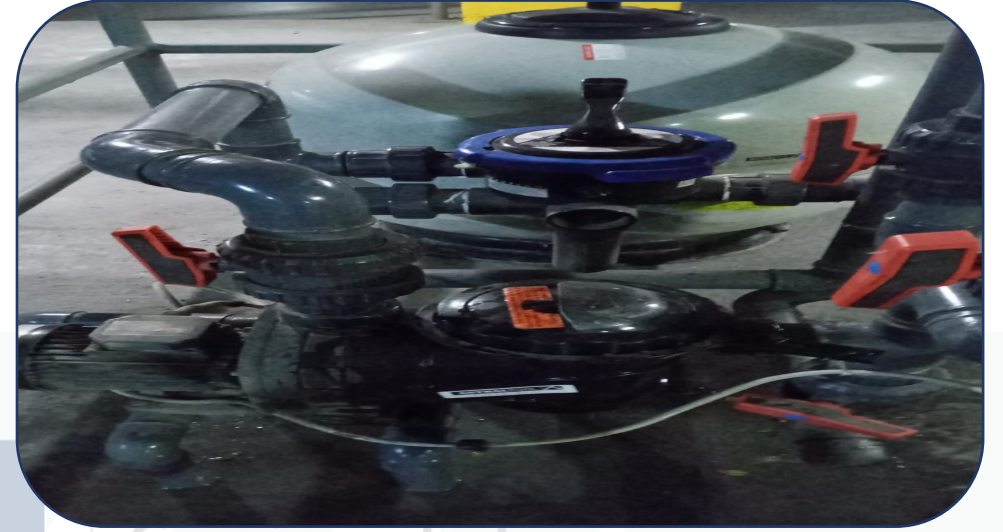
Süs havuzlarının sirkülasyon pompa görseli
