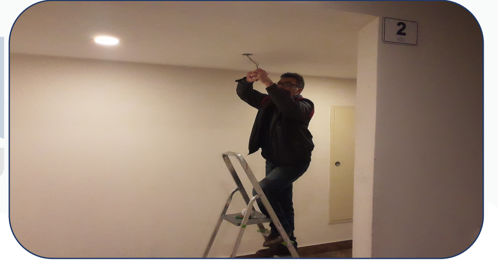
Blok içi arızalı aydınlatma ve sensörler değiştirilmiştir.
