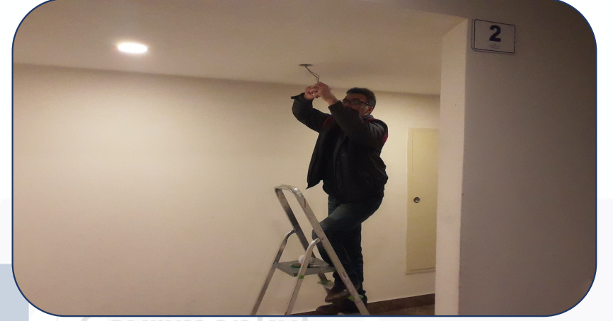
Blok içi arızalı aydınlatma ve sensörler değiştirilmiştir.
