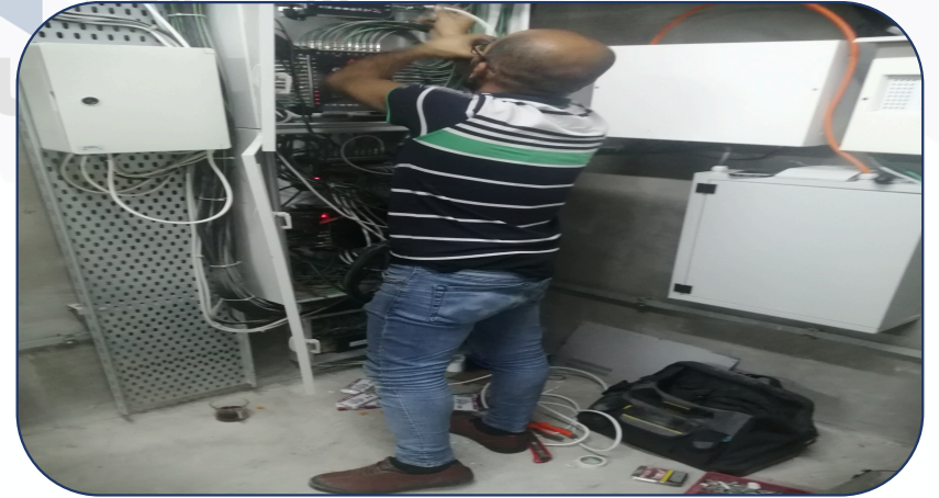
C Blok uydu yayın sistemi arızası giderilmiştir.
