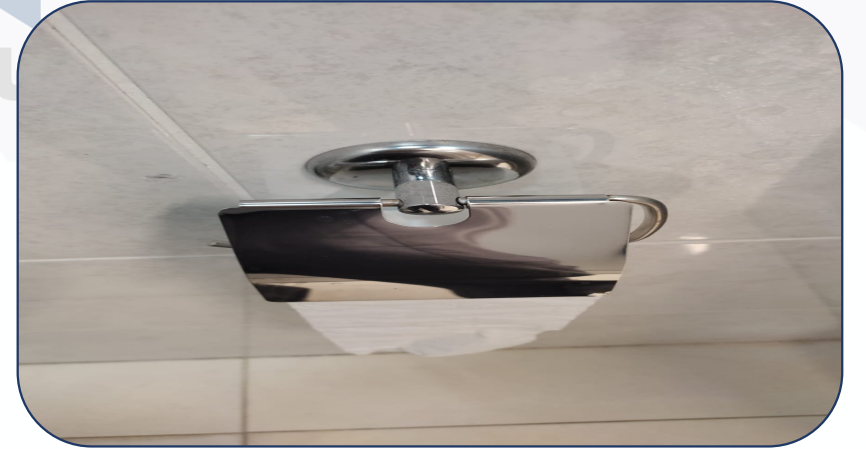
Tuvalet kağıtlığı değiştirilmiştir.
