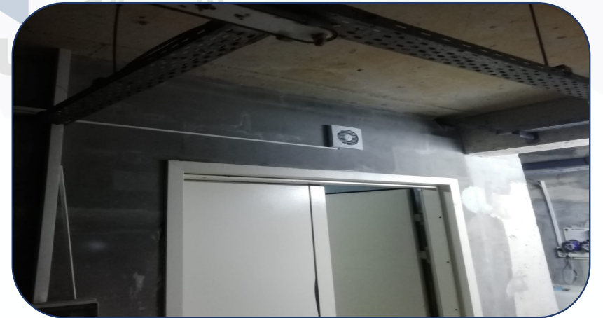
Havuz makine odasına havalandırma sistemi takılmıştır.
