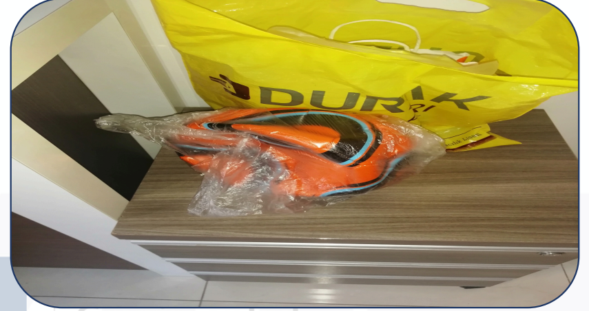
Otopark temiz su gider hattına pis su karıştığından futbol topu şişirilerek köpük sıkılarak hat kapatılmıştır.
