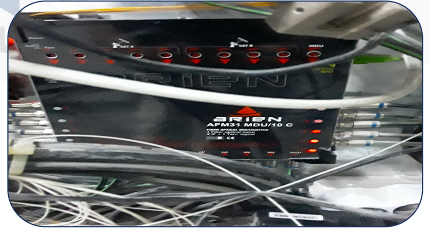
C Blok uydu yayın sistemi arızası giderilmiştir.
