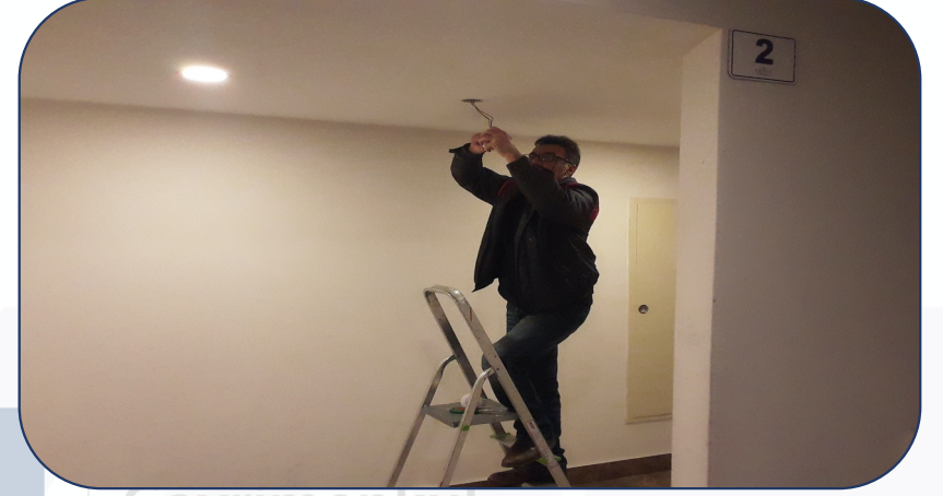
Blok içi arızalı aydınlatma ve sensörler değiştirilmiştir.
