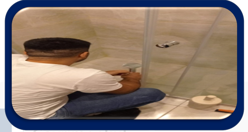
Dairelerden alt katlara sızan sulara müdahale edilmiştir.
