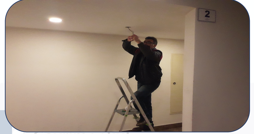
Blok içi arızalı aydınlatma ve sensörler değiştirilmiştir.
