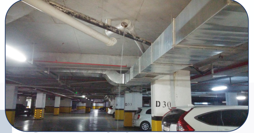
D blok otopark su kaçağı arızası giderilmiştir.
