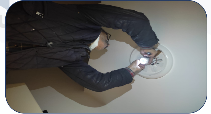
Arızalı sensörler değiştirilmiştir.
