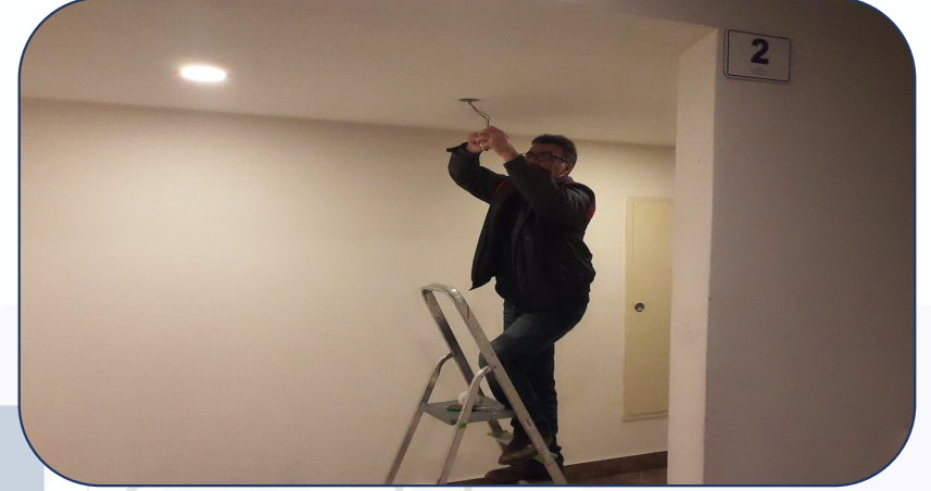
Blok içi arızalı aydınlatma ve sensörler değiştirilmiştir.
