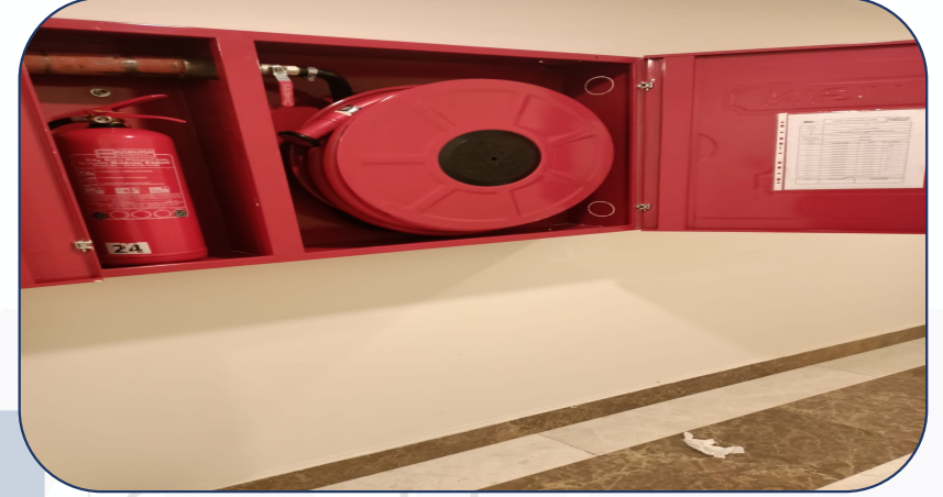
Yangın dolapları düzenli olarak temizlenmektedir.
