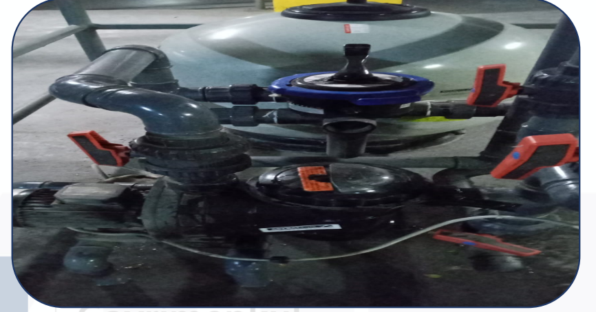
Süs havuzlarının sirkülasyon pompa görseli
