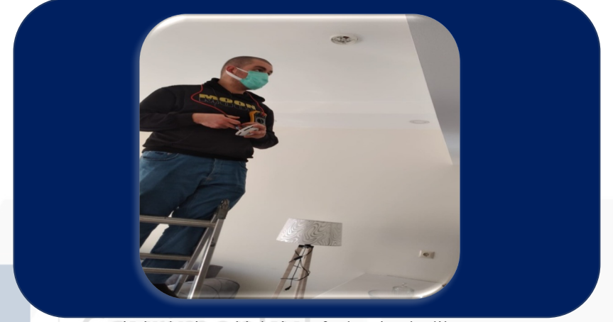
Dairelerde site sakinleri tarafından iptal edilen yangın alarm dedektörleri tespit edilip aktifleştirilmiştir.
