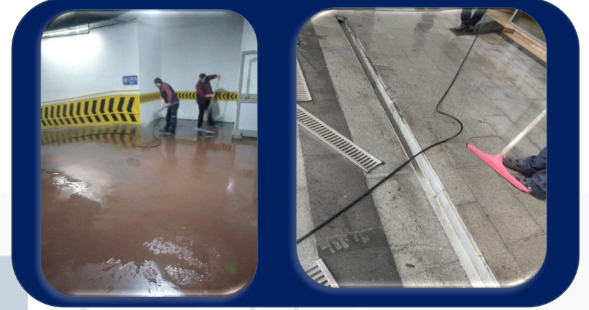
site girişindeki mazgalların temizliği ve otoparkın girişi teknik personellerimiz tarafından temizlenmiş ve site genelinde uygulama devam etmektedir.
